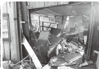
③崩壊した建物
